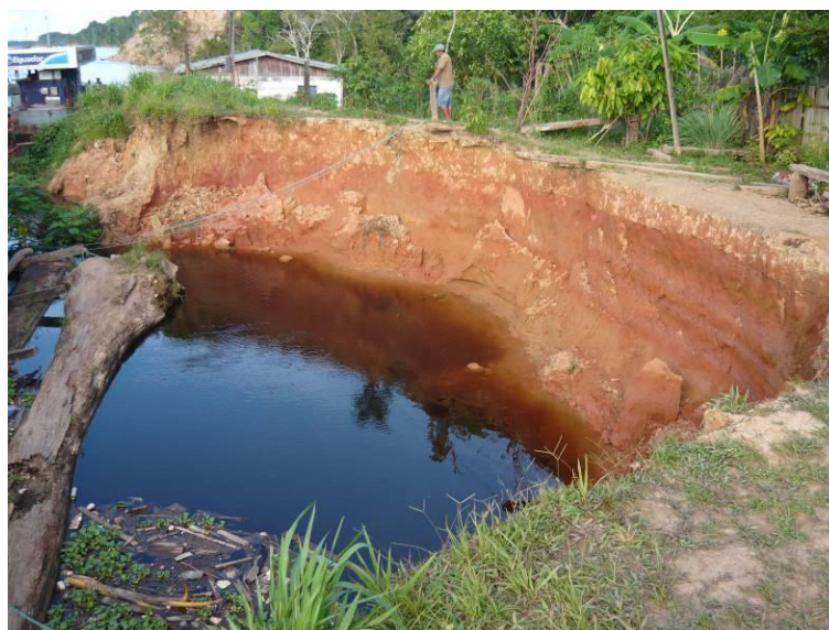
Figura 7 – Voçoroca na frente da cidade de Jutai.
